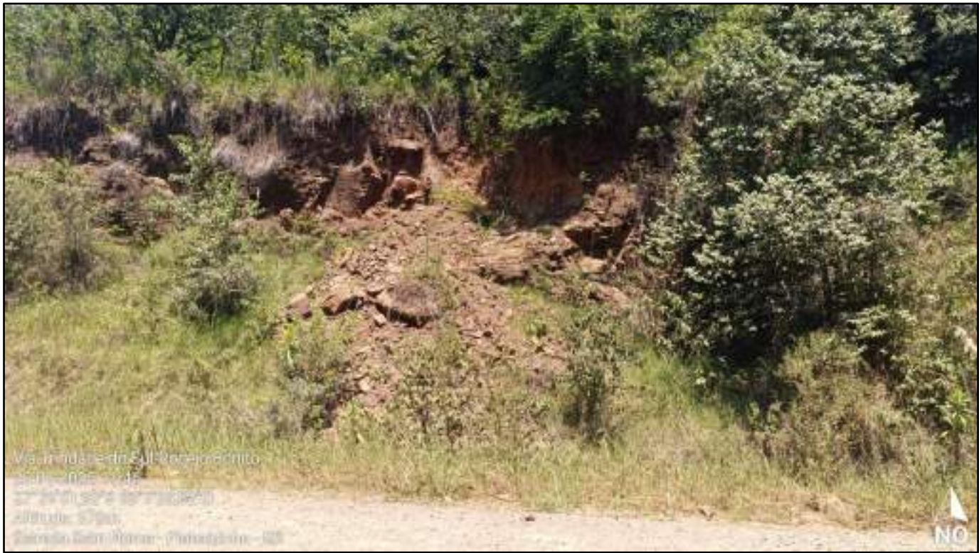
Figura 24. Porções de basalto decomposto encontrado caídos a base de talude encontrado ao lado da via estudada.
