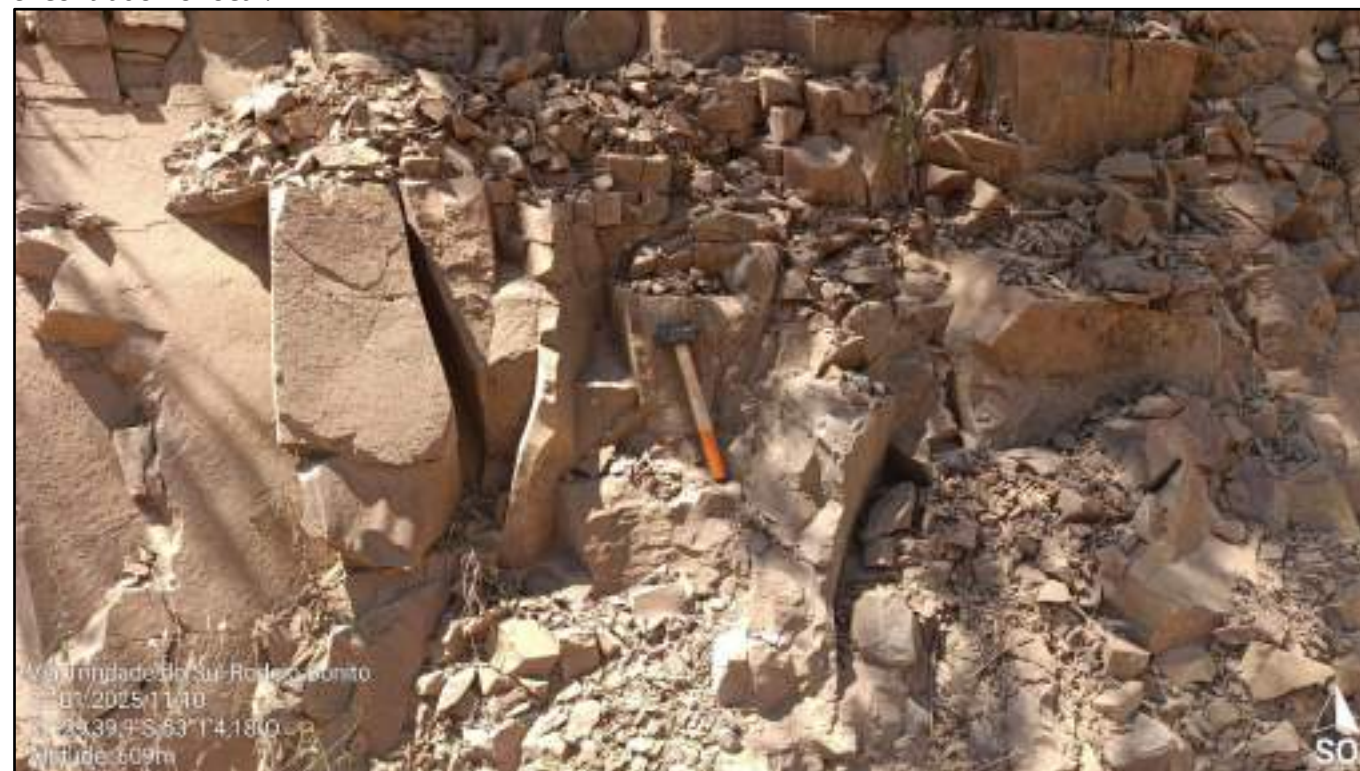
Figura 15. Vista de talude ocorrendo nas margens da estrada, apresentado o padrão de fraturamento encontrado no local.
