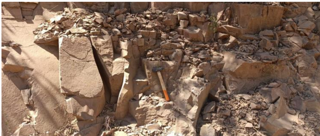
Figura 2 – Talude rochoso com fraturamento ao longo da estrada.
