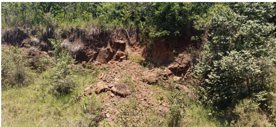
Figura 10 – Porções de basalto decomposto encontrado caídos a base de talude encontrado ao lado da via estudada.
